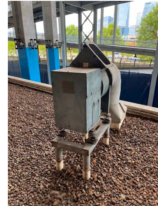
Kitchen exhaust fan Quad B
