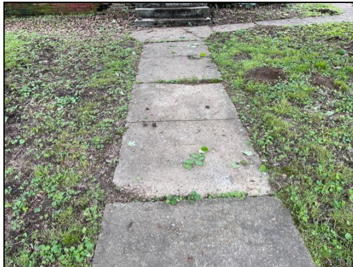
34. Uneven (trip hazard)
